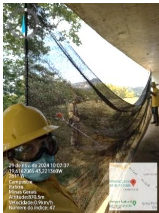
Figura 18: Tela utilizada para evitar que projeteis causem danos materiais e acertem pessoas.
