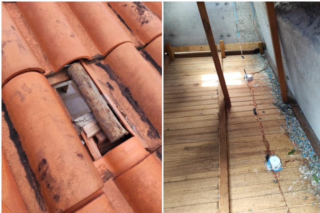
Figura 1: Reparos e remoção das maritacas do forro da sala administrativa no CAT.
