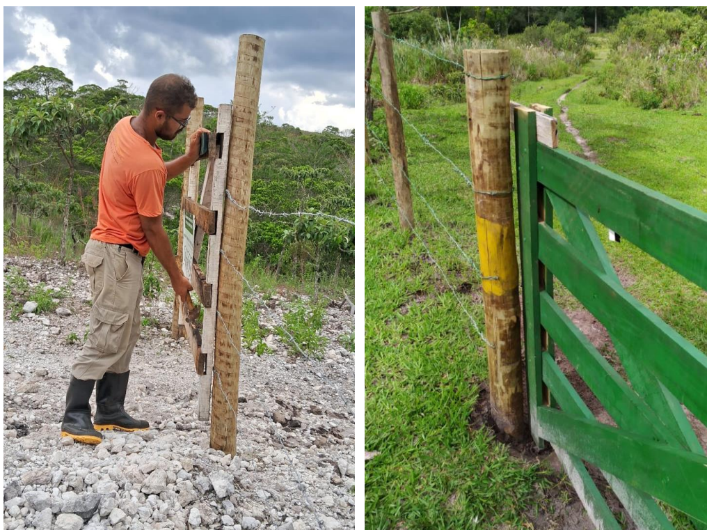
Figura 19: Reparos realizados nas porteirosas.
