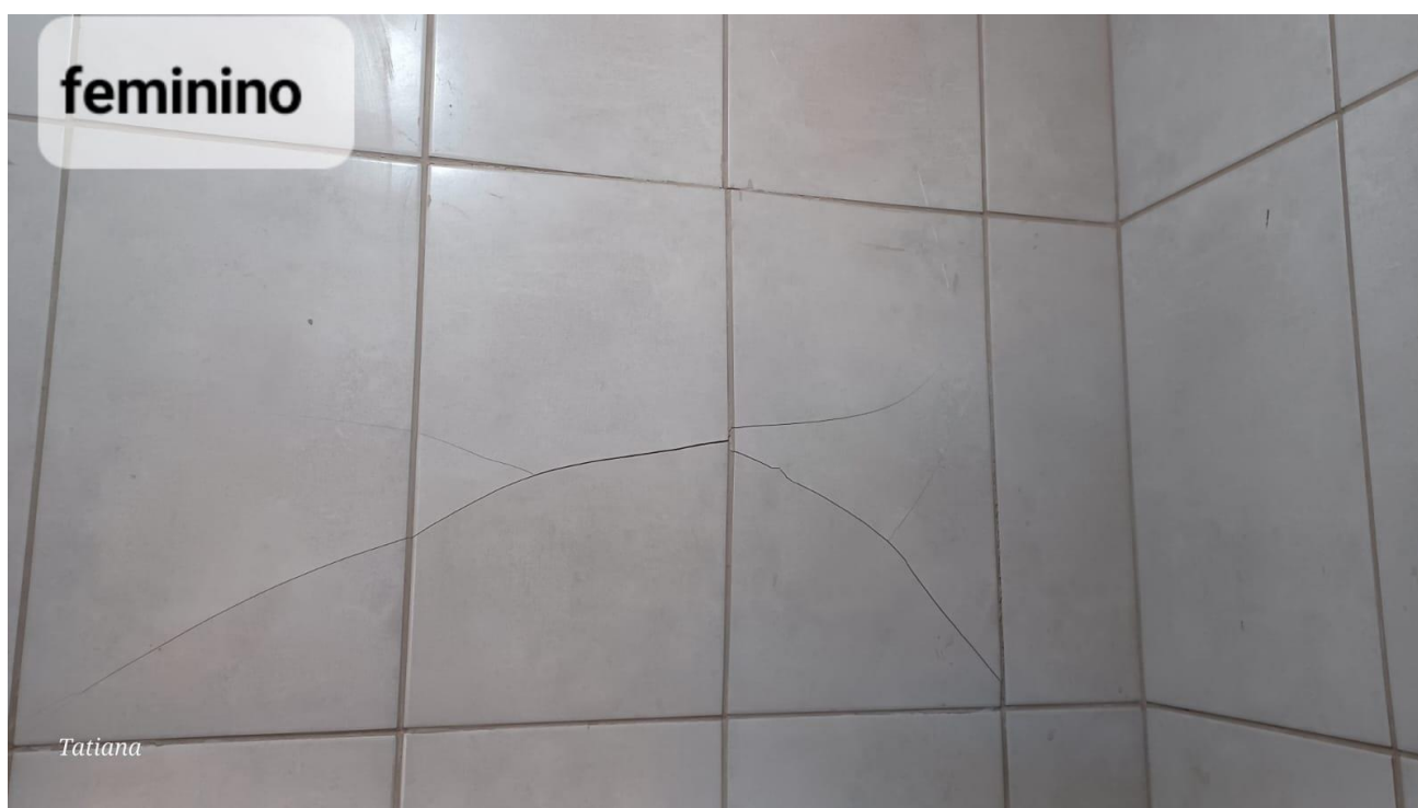
Figura 2: Parede do banheiro danificado por rachaduras.
