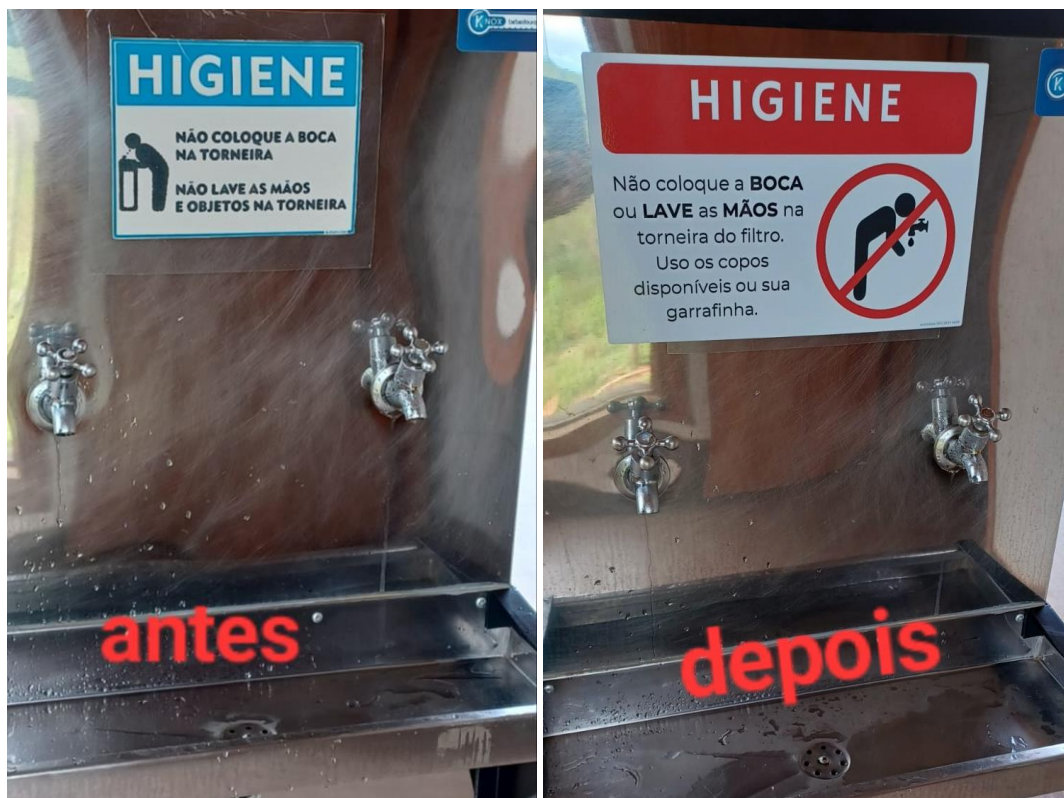
Figura 1: Instalação de placa de advertência para usarem copos ou garrafas para pegarem água no filtro.
