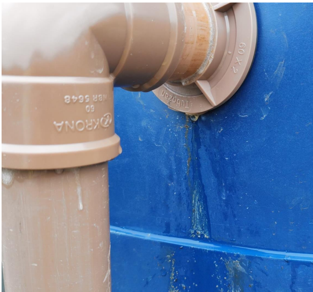
Figura 28: Vazamento observado na biodigestora instalada.
